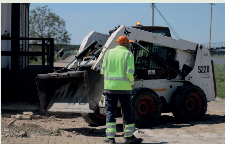
Toda a zona verde da Margem Sul ficou extremamente danificada e revolvida. A requalificação, ainda em andamento, envolveu vários grupos de trabalhadores.
